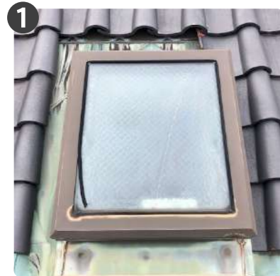
工事前の古い天窗
