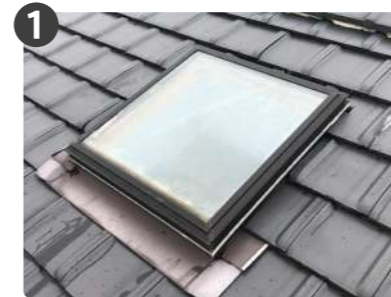
工事前の古い天窗
