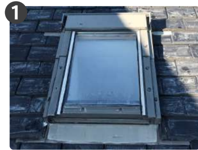
工事前の古い天窗
