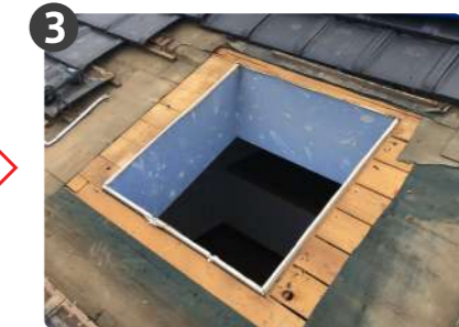
天窗全てを撤去し、野地にできる余白部分に黒い防水シート等で化粧
