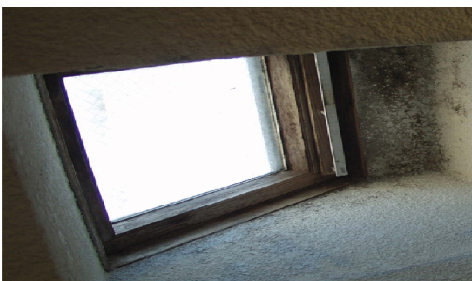
7、施工前の内部状況(カビが全面に付いた状態)
